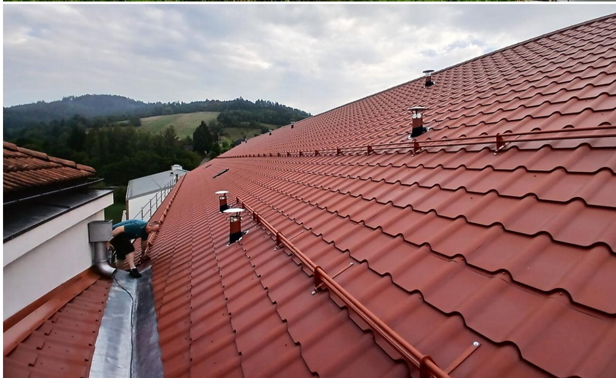
Generální oprava střešního pláště budovy B. Investice ve výši 2 566 152 Kč bez DPH
